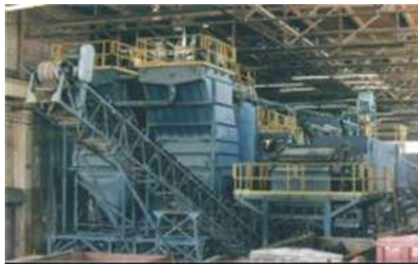
FIG 4-13 Unidade de Tratamento no Canadá ( http://www.art-engineering.com/Projects/Montreal/Photos.htm [acesso 2008])
