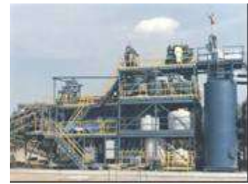
Unidade de tratamento
